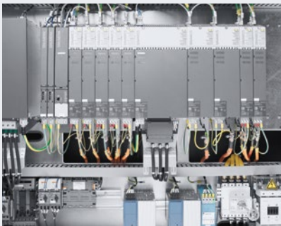
Antriebe: Energierückspeisung während der Bremsphasen von Spindeln und Vorschubantrieben
